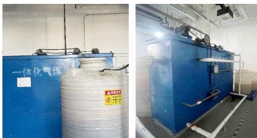
江門基地園區廢水處理設施
