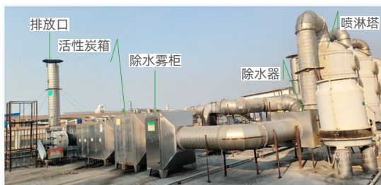
升級改造後的廢氣處理系統
